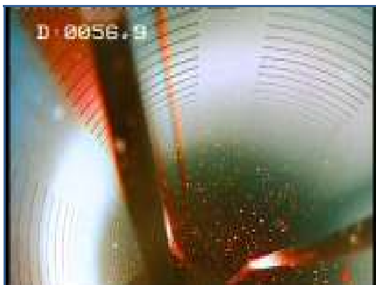
Présence de traces brunâtres sur une génératrice
